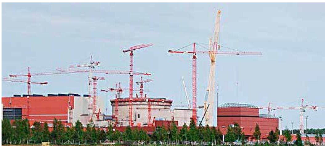
Kuva 41. Suurella työmaalla on useita torninostureita. Nostureiden sijoituksia ja liikealueita suunniteltaessa on otettava huomioon myös se, että nosturit eivät saa törmätä silloinkaan, kun käyttö on lopetettu ja puomi pääsee kääntymään vapaasti tuulen mukana.
