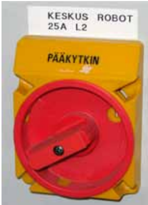
Kuva 23. Tässä syötönerotuskytkimessä (pääkytkimessä) on paikat kolmelle riippulukolle.
