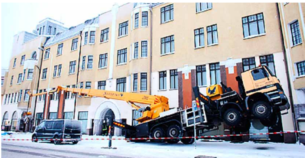
Kuva 44. Jalkakäytävän peittäminen tukijalan alla aiheutti puomin ja nostokorin iskeytymisen talon seinään. Korin kiinnityspultit katkesivat, mutta kori jäi roikkumaan kaapeleiden ja paineilmaletkujen varaan. Korissa olleet kaksi työntekijää eivät käyttäneet turvalajajaita ja putosivat maahan asti ja kuolivat. TOT 1/2010
