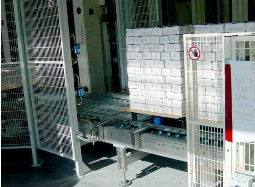
Kuva 2. VÄÄRIN. Aitaan jätetty aukko tekee mahdolliseksi automaattisen konelinjan vaarakohtiin pääsemisen minkään turvalaitteen havaitsematta. Toimitus on siten selvästi säädösten vastainen. Puuttuvaa aitaa ei voi korvata kieltomerkillä.
